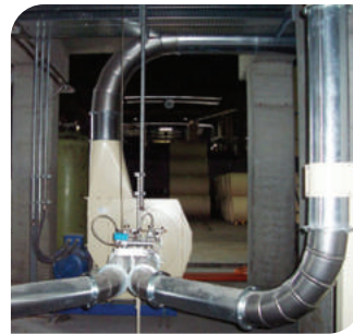
Ventiladores Destroçadores Ventiladores Astilladoras Fan-tearing Units
